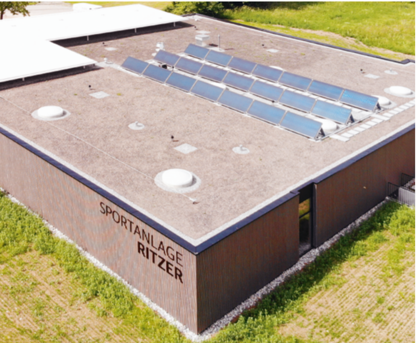
Installation solaire thermique
